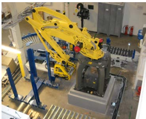
Stacja paletyzacji na chwilę przed uruchomieniem instalacji
